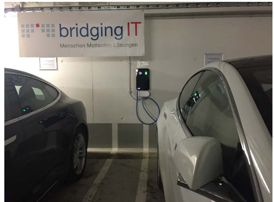
Foto: Ladestationen am Standort München
